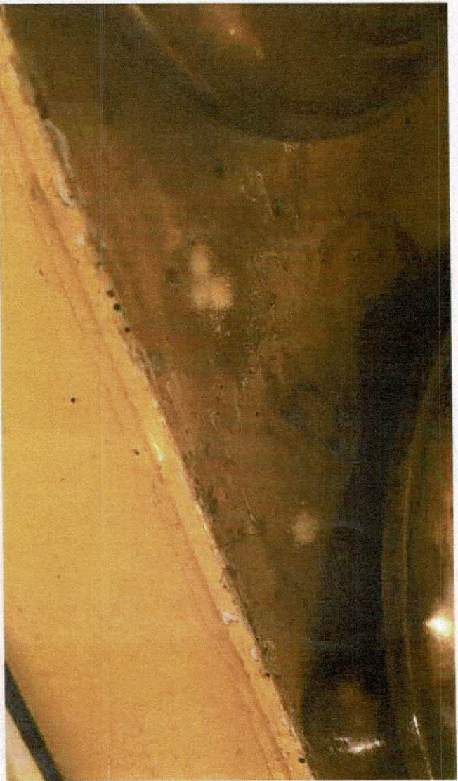
Mączka drzewna oraz otwory wylotowe po owadach ksylofagicznych, świadczące o aktywnym żerowaniu drewnoładów w ołtarzu.
